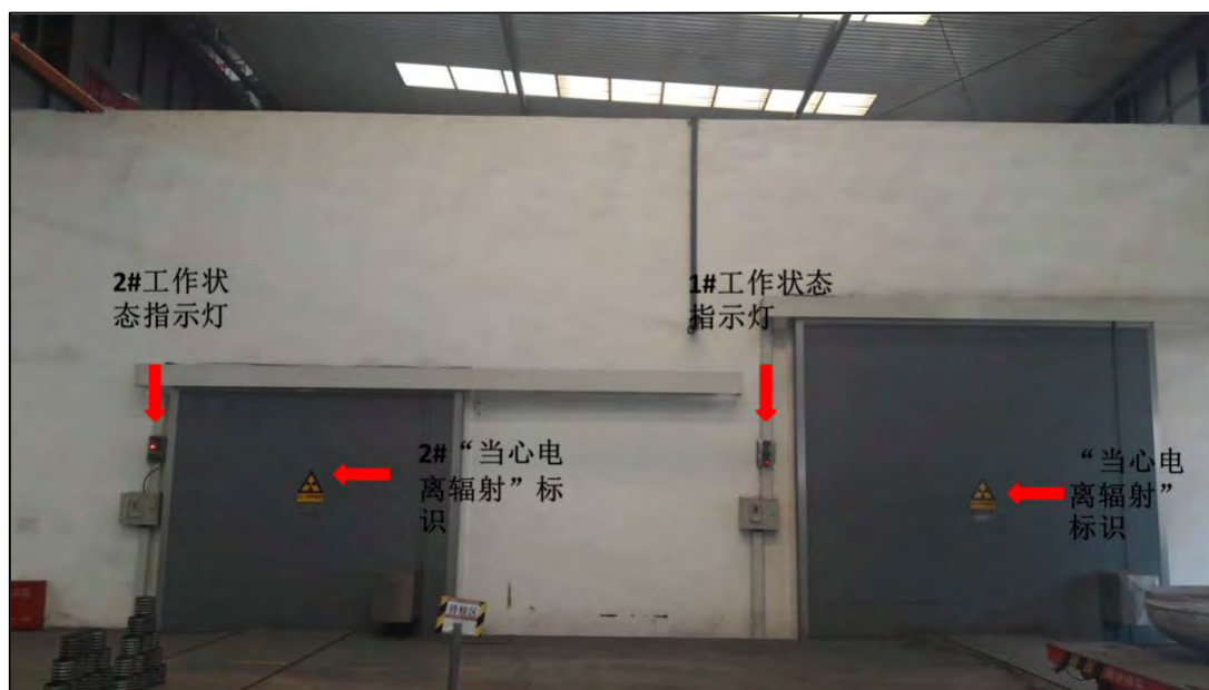
照片 20 1#、2#探伤室工件进出门“当心电离辐射”标识、工作状态指示灯
