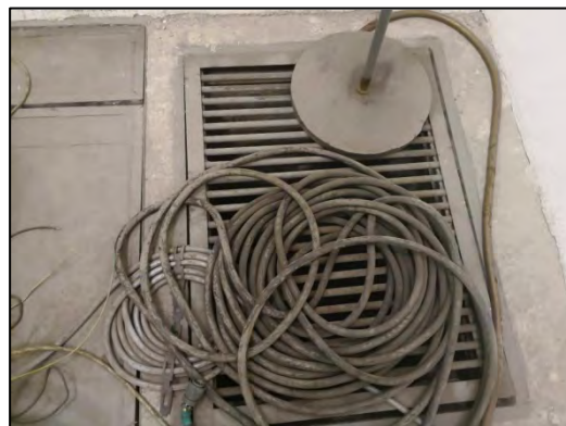
照片 13 2#探伤室室内排风口
