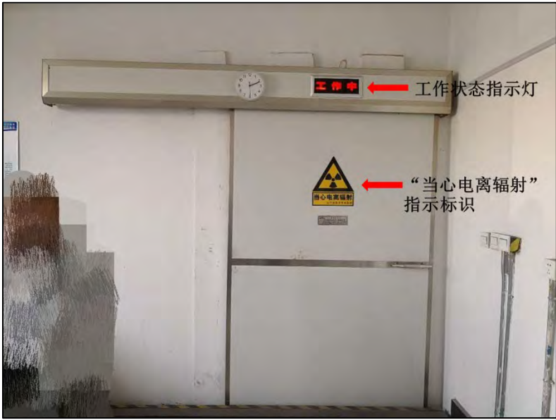
照片 6 1#探伤室“当心电离辐射”标识、工作状态指示灯
