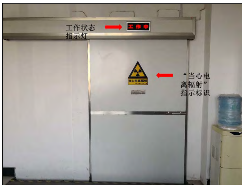
照片 11 2#探伤室“当心电离辐射”标识、工作状态指示灯
